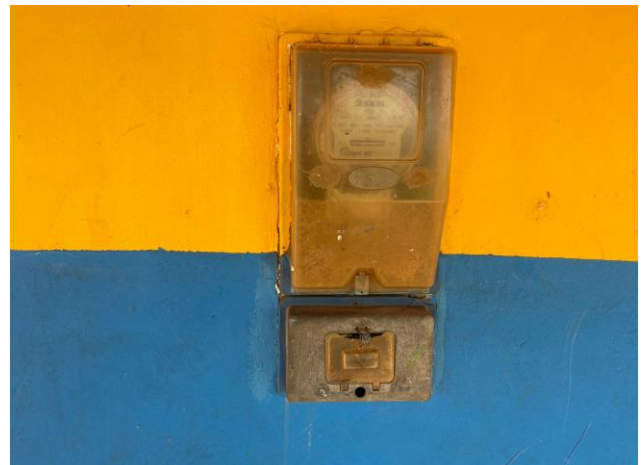
QUADRO DE DISTRIBUIÇÃO
